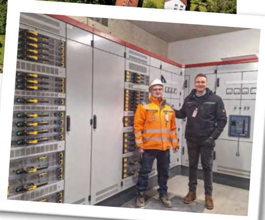
Projektleiter Frank Pfeifer (l.) und Rene Förster im Herzstück des Gebäudes: der Stromversorgung
